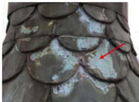
Corrosion du lanterneau, Gloriette de Buffon © ssea-Botton
