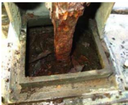
Corrosion des pieds de poteau, Gloriette de Buffon © ssea-Botton
